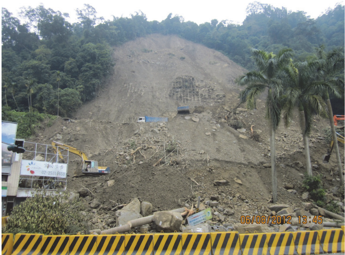
圖 18 觸口路段崩塌(2012.8.6 攝)
