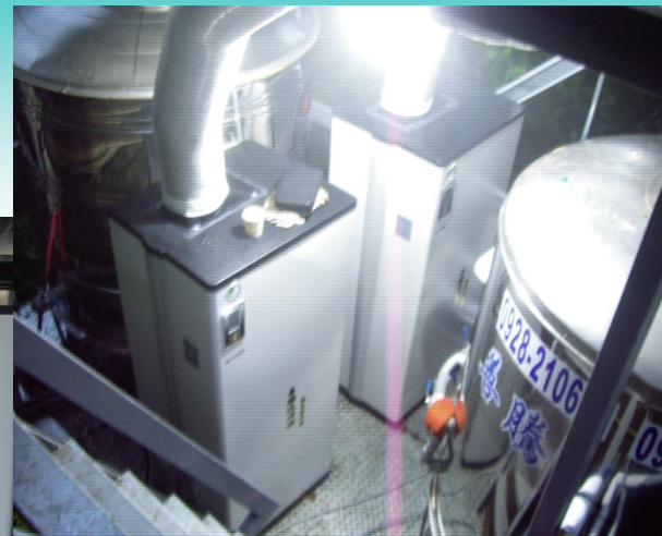
熱泵主機及儲熱水槽
